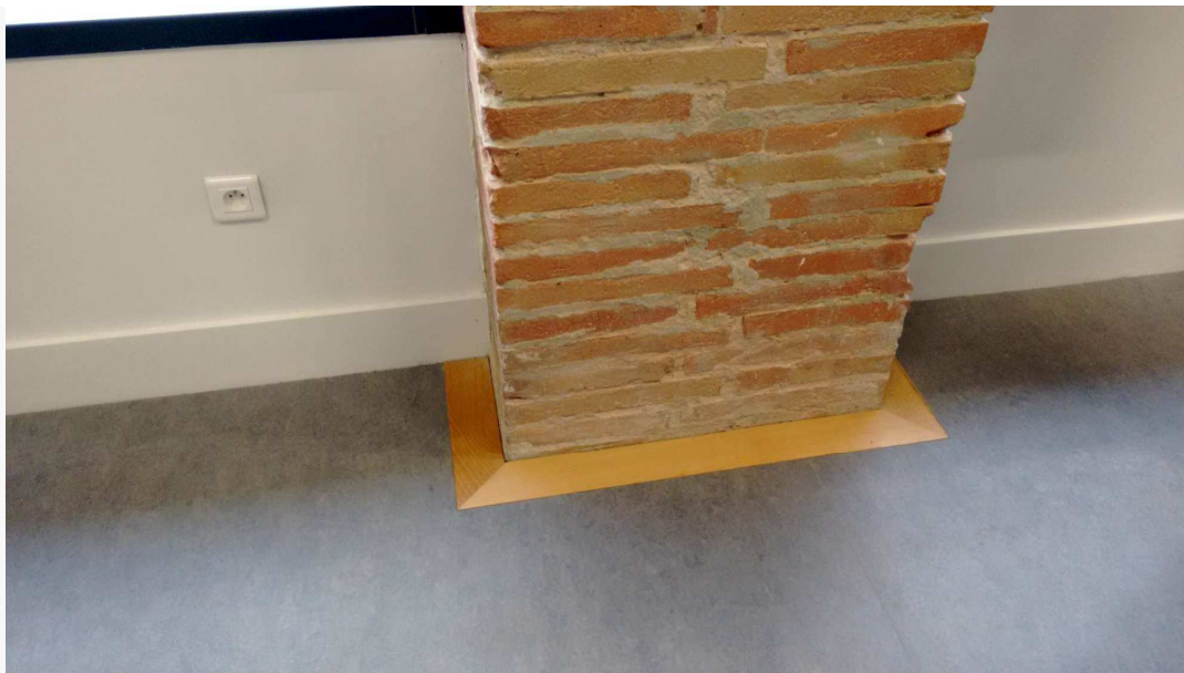
Figure 8 : Rappel des remontées de liège autour des piles en brique (source : CeRCAD)
