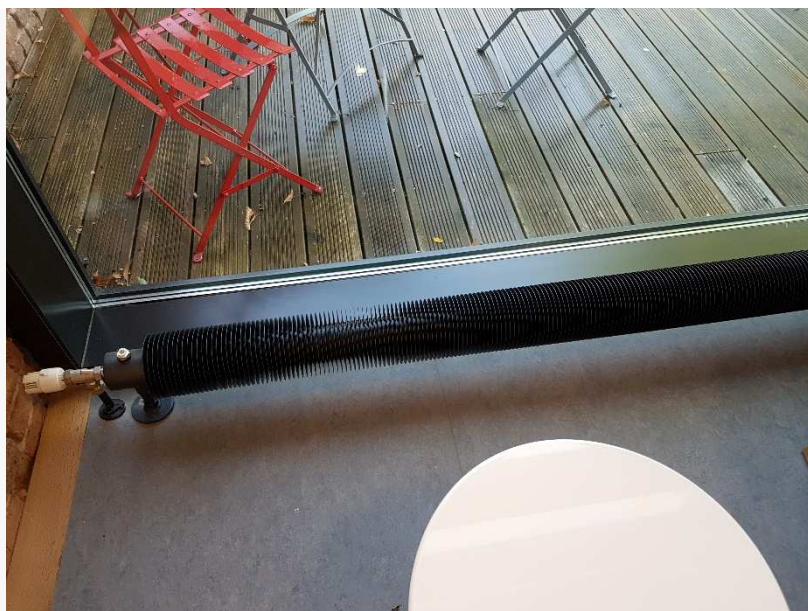
Figure 19 : Radiateurs à eau partie médiathèque
