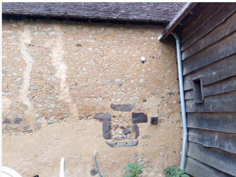
Illustration 14 : Gouttière à l'angle entre l'atelier et l'extension (source CREBA)
