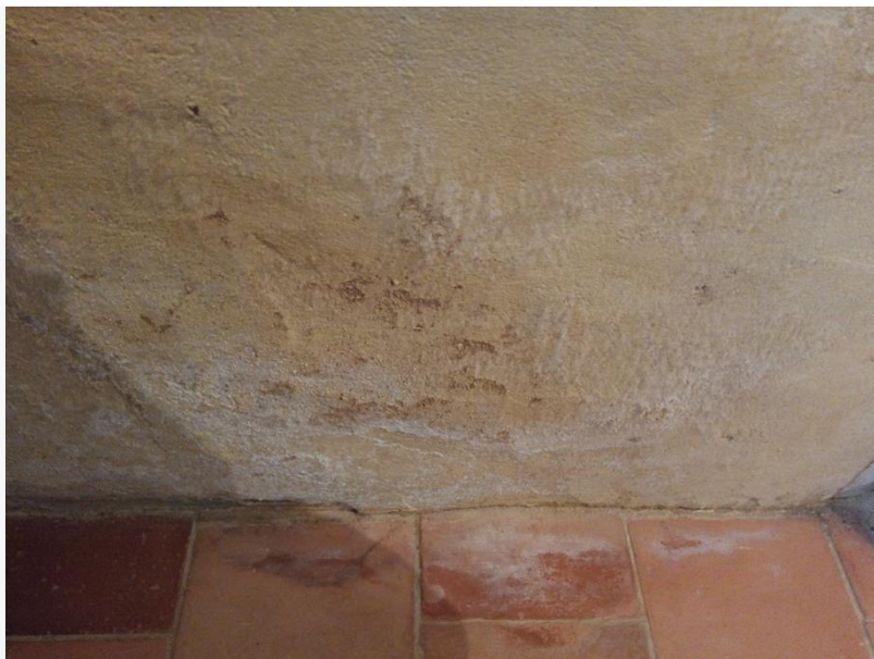
Illustration 13 : Traces de salpêtre (source : CREBA)
