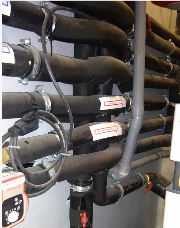
Figure 28 : Calorifugeage des réseaux en polyuréthane (source CREBA)
