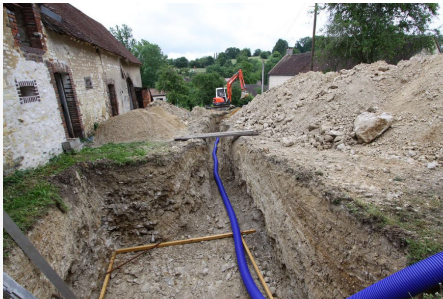
Figure 33 : Puits canadien en fond de tranchée
