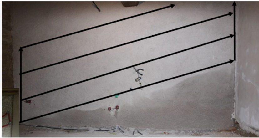
Figure 14 : La zone sans drain en bas à droite est toujours humide
