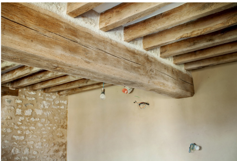
Figure 8 : Poutre surdimensionnée pour l'étage (source : CREBA)
