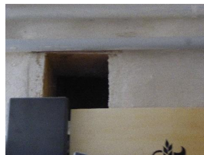
Figure 32: Ouverture pour la circulation de l'air entre les caves individuelles (Source : Cerema)
