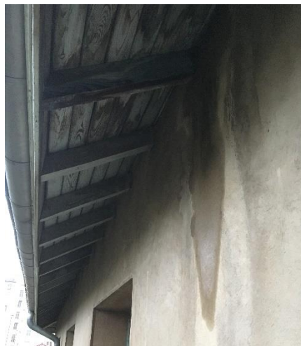
Figure 7: Fuites sous la couverture en tête de mur
