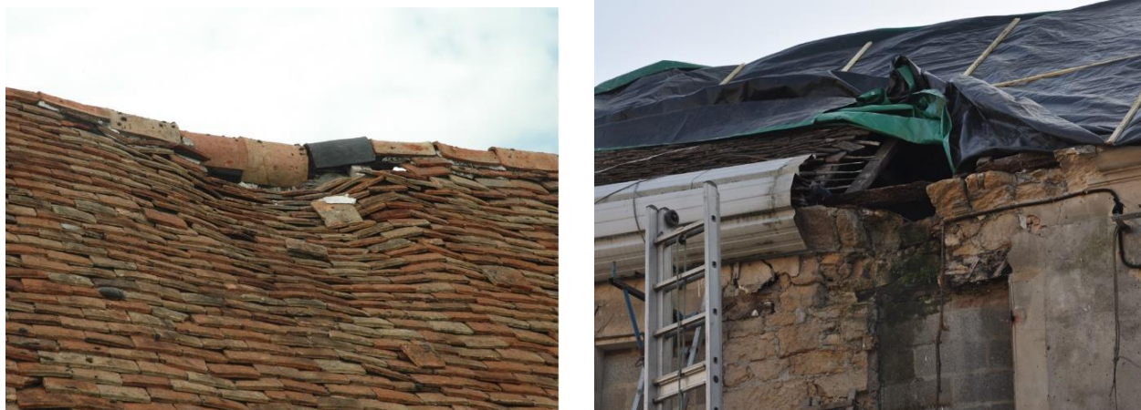
Figure 4 : Des failles dans la couverture et au niveau de la corniche
