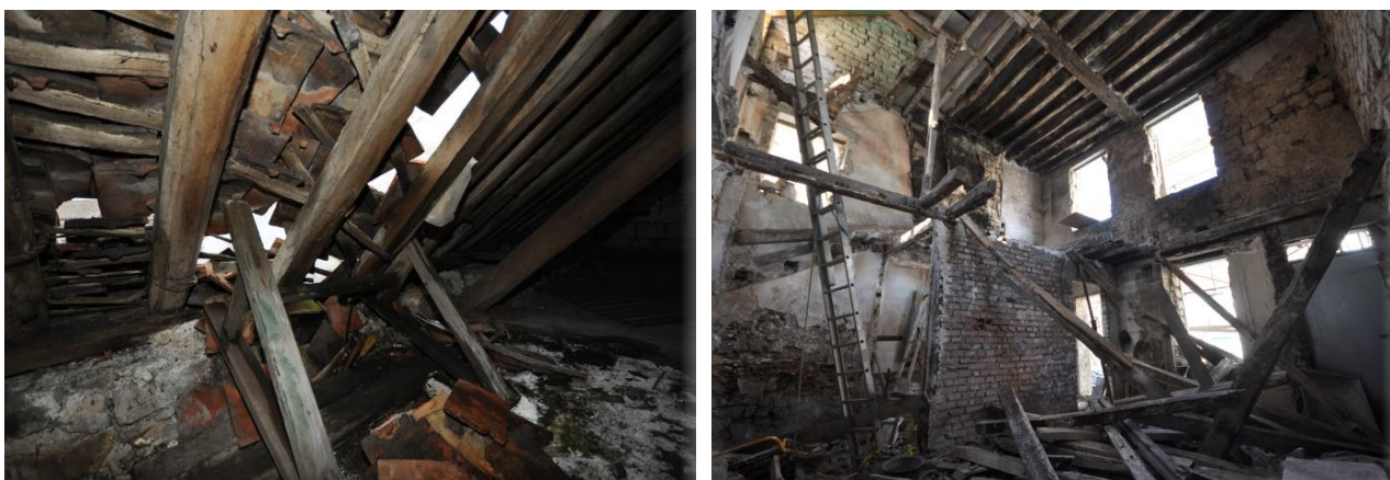
Figure 3 : Les infiltrations d'eau par la toiture ont mis en péril la bâtisse
