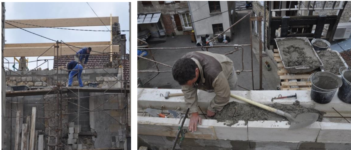
Figure 8 Consolidation de la structure et reprise de l'arase avant pose de la charpente
