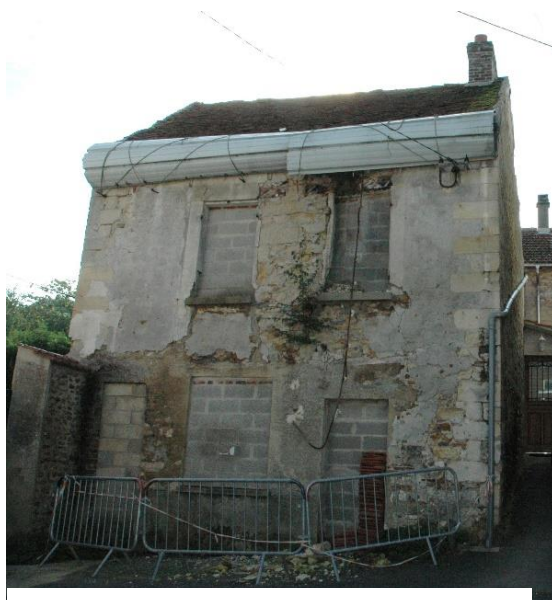
Figure 2 : La façade nord montre l'état de délabrement de la maison
