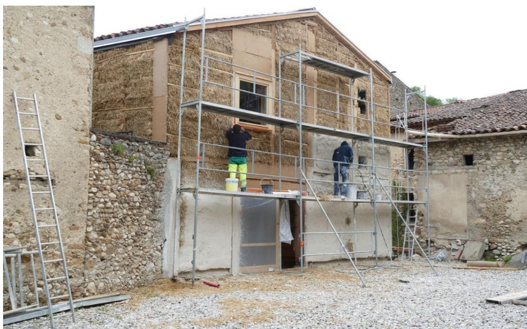
Figure 18 : Installation de la paille d'isolation côté jardin de l'extension en ossature bois, sur la façade ouest de l'extension
