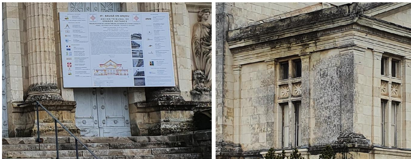
Figure 8 : Érosion du tuffeau avant travaux – À gauche : colonnade centrale – À droite : aile Est
