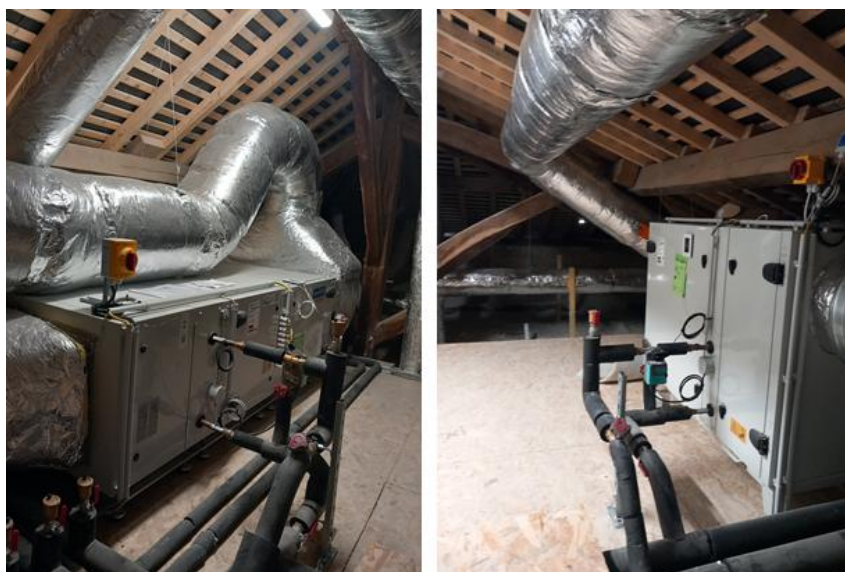
Figure 24 : Équipements de VMC installés dans les combles
