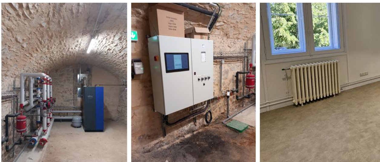
Figure 23 : Équipements de chauffage – Chaudière, GTC, radiateurs en fonte
