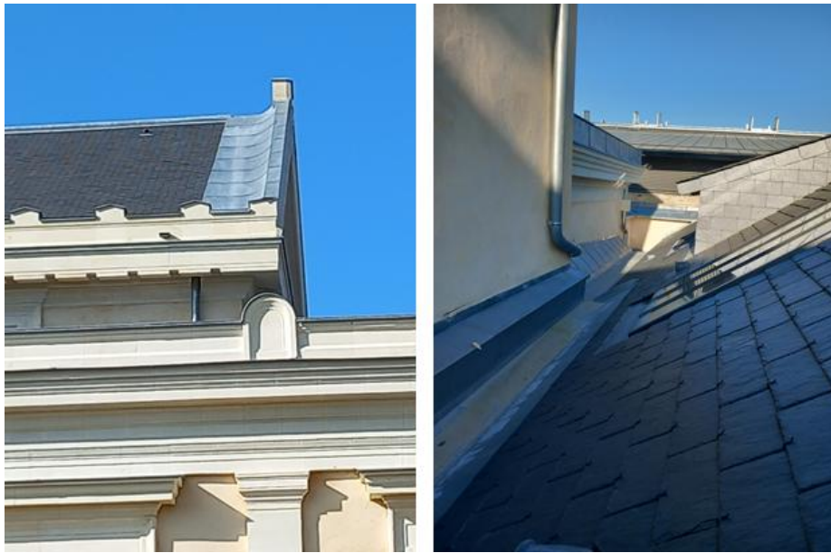
Figure 13 : Protections en zinc du tuffeau
