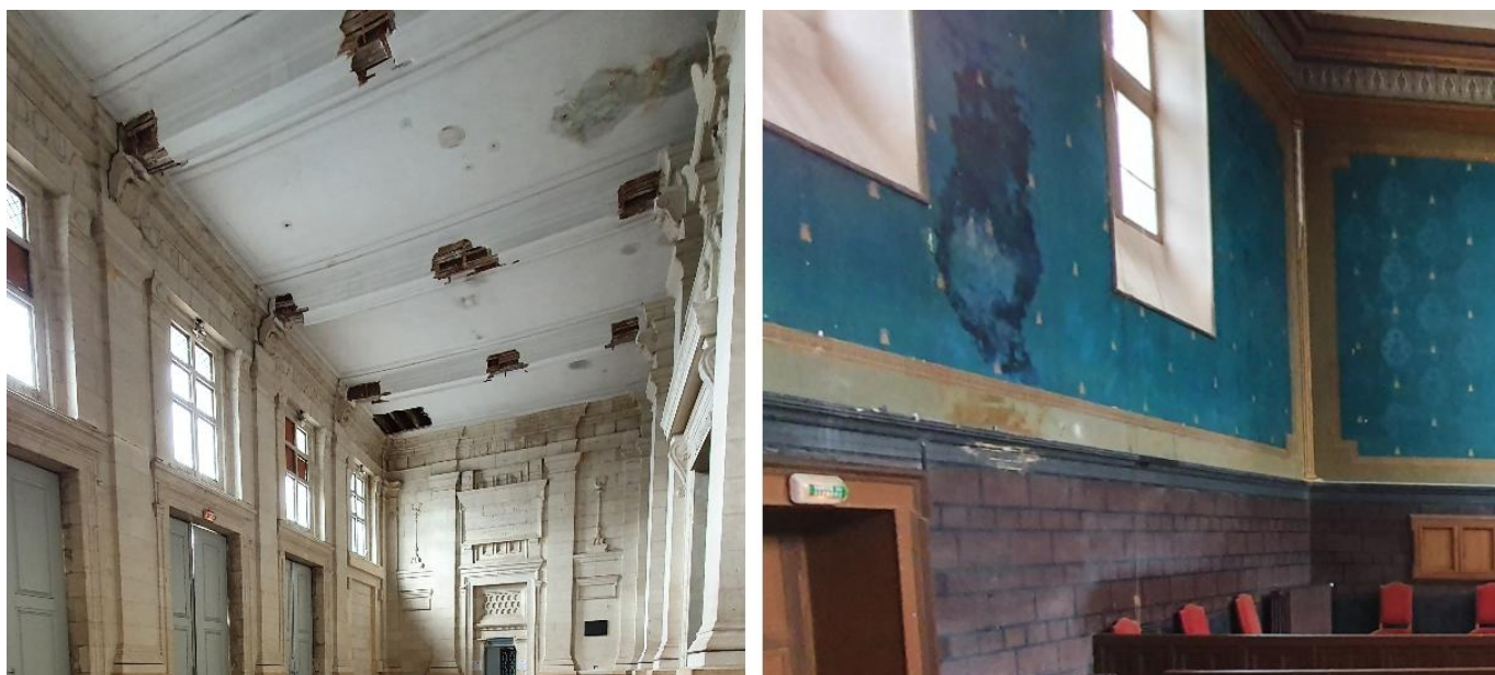
Figure 7 : Infiltrations avant travaux – À gauche : Plafonds de la salle des Pas perdus – À droite : Papiers peints de la salle des Audiences
