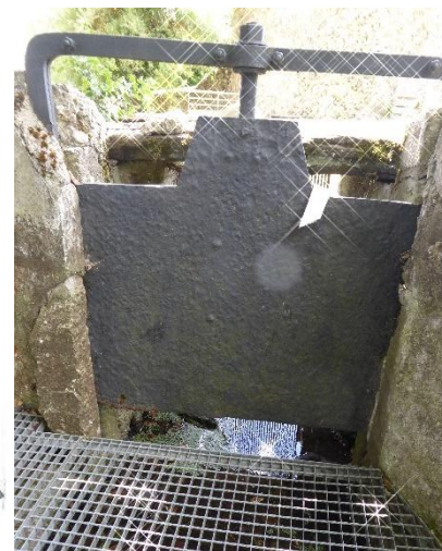
Figure 12 : Écluse permettant de gérer l'arrivée de l'eau selon les besoins Source : Cerema
