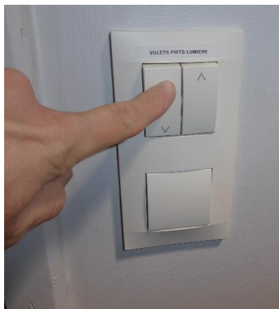
Figure 30 : Ils peuvent être occultés via une commande manuelle
