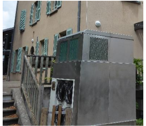
Figure 24 : Condenseur d'eau Source : Cerema
