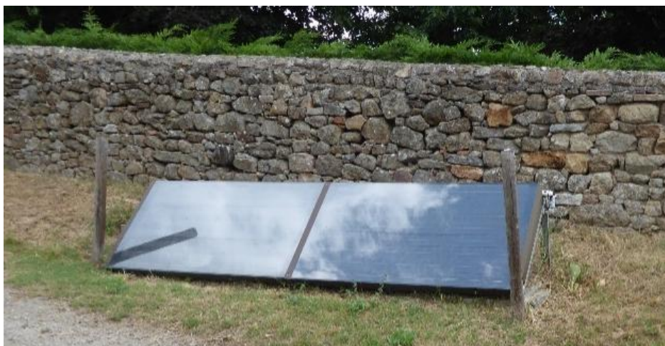
Figure 50 : Panneau photovoltaïque au sol dans le jardin Source : Cerema
