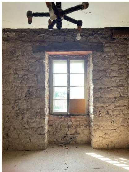
Figure 9 : Linteau en briques sur la façade atteinte par la m r le
