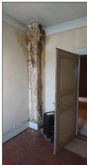
Figure 10 : D sordres li s   des infiltrations d'eau le long du conduit de chemin e
